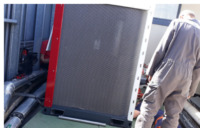
Groupe de climatisation - établissement thermal
