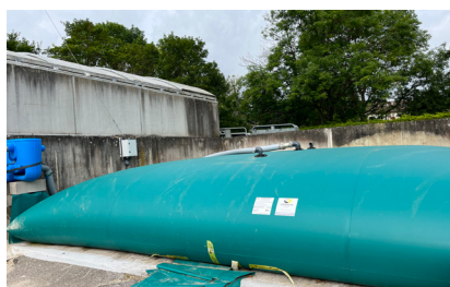
Récupérateur d'eau - ateliers municipaux
